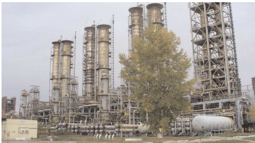
6. Instalacja produkcji ciężkiej wody
