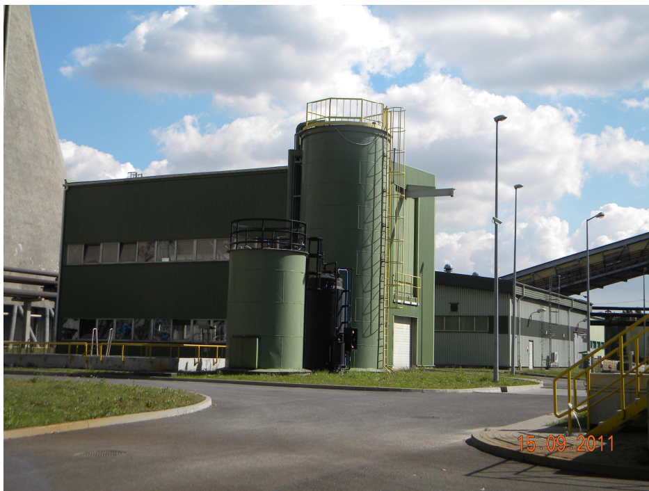
Fot. 3 Urządzenia gospodarki wodnej Elektrowni Łagisza - widok na oczyszczalnię ścieków przemysłowych
