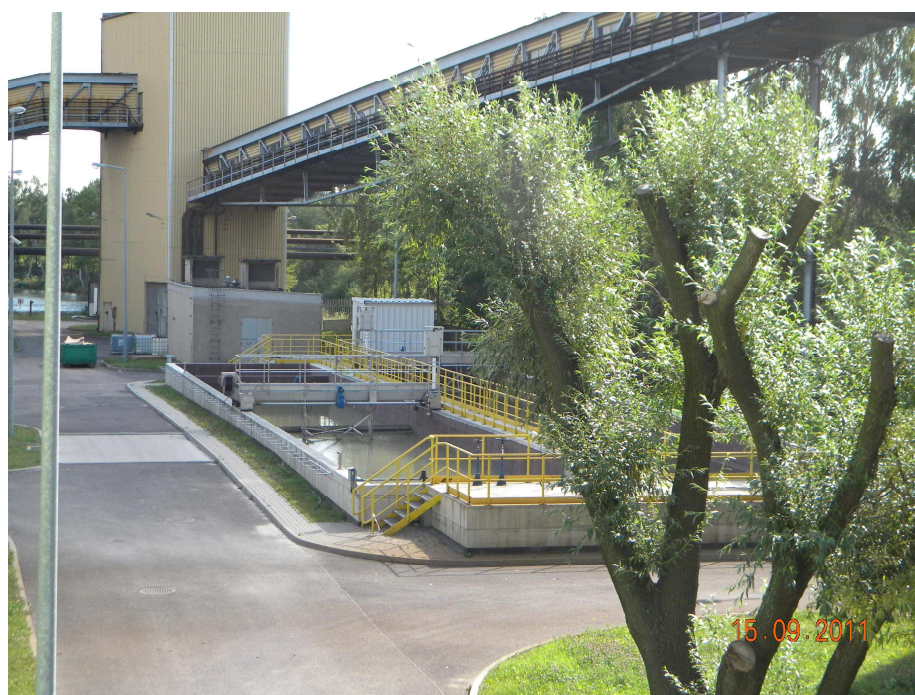
Fot.1 Urządzenia gospodarki wodnej Elektrowni Łagisza – węzeł wstępnego oczyszczania ścieków przemysłowych
